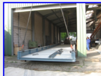
Montage in einer Verladeanlage
